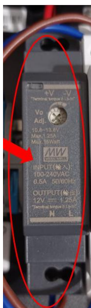
Figura 14 – Conversor de tensão AC/DC da Câmera LPR
